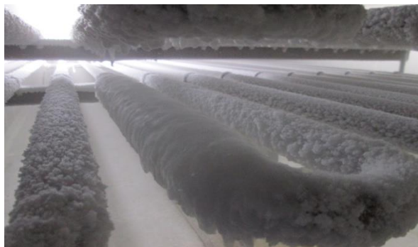
排管表面结霜情况
